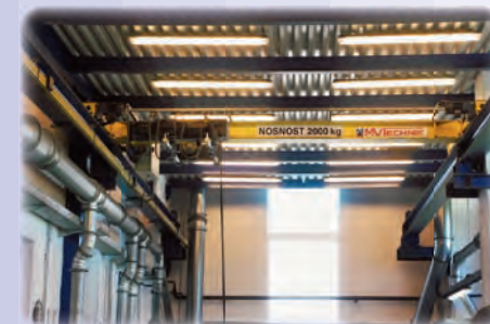
Mostový jeřáb Traveling crane
